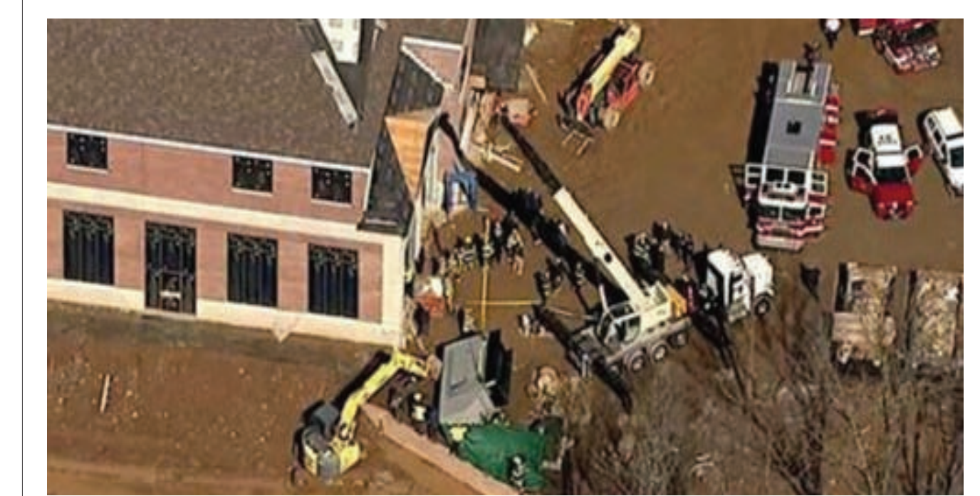
綜合報導 美國新澤西州的一處建築工地，于當地時間18日發生事故，導致1人死亡，1人受傷。 報道稱，美國職業安全與健康管理局發言人表示，在事故發生後，當局已經派出一位檢查員前往事故現場。從現場畫面可以看到，一個大型發電機傾翻在地，而當局也在試圖確認事故發生原因。 據悉，當時建築工人正在試圖將大的一條突然斷裂。 在事故發生後，趕到現場的一名承包商代表表示，目前並不清楚是繩子本身問題還是天氣導致。他還透露，事故發生時，風很大，繩子又是新換的。 職業安全與健康管理局調查人員和警方目前正在現場調查，有關這起事故中遇難的受害者和另外一名傷者的身份尚未公布。
