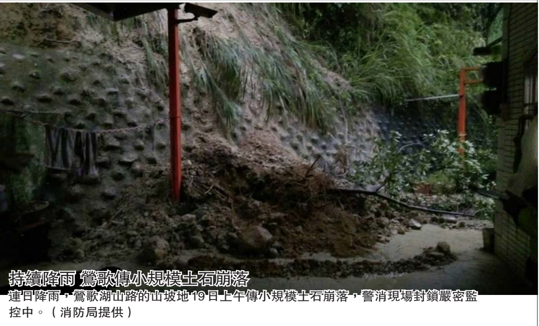
持續降雨，當歌湖山路的山坡地19日上午傳小規模土石崩落，警清現場封鎖嚴密監控中。（消防局提供）
